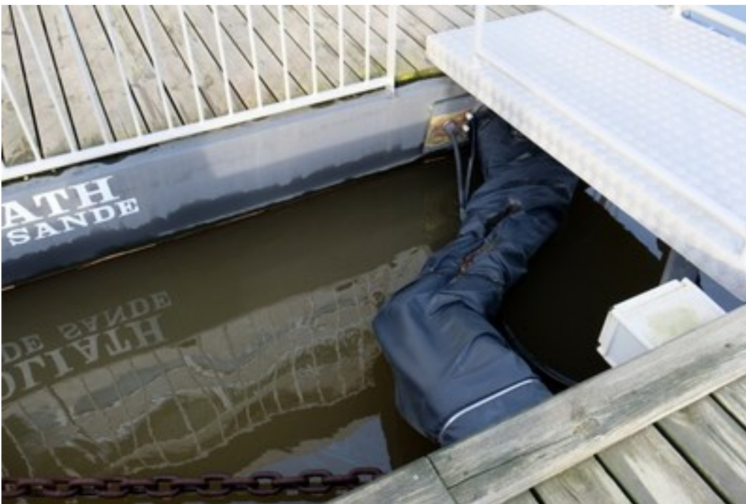
De landfaste husbåde har en fleksibel slange med el, vand, spildevand og fjernvarme.
